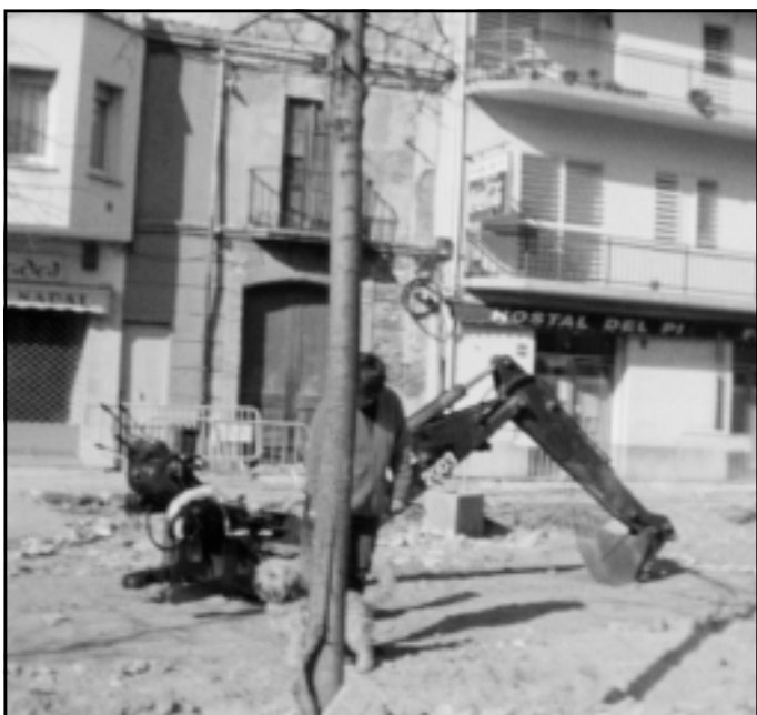
Plaça del Pi en obres, arbres malmenat per les màquines. Abril de 1999.
